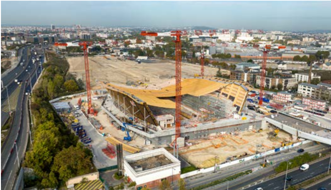
Chantier de la piscine du Centre aquatique olympique de Saint-Denis, en octobre 2022
